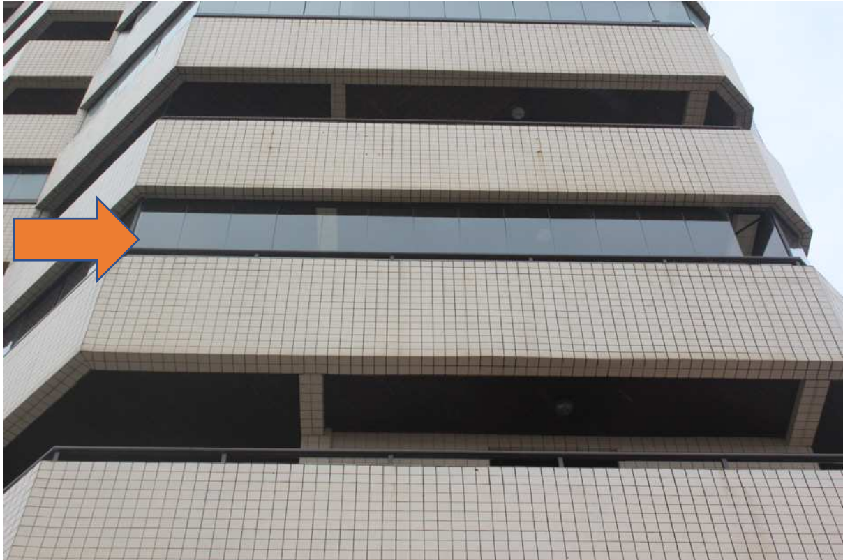
Situação Paradígma – Apartamento Nº 301 (Bloco “A”)
