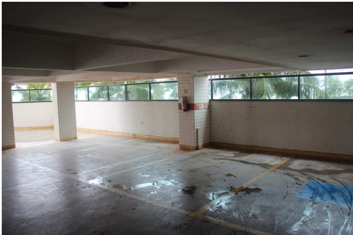
Condomínio Residencial Edifício Janete Mariano – Garagem
