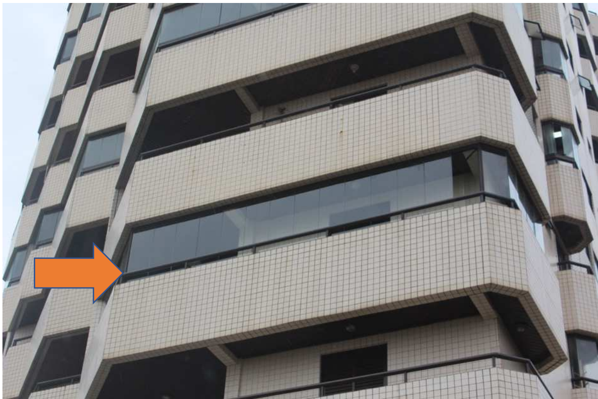
Situação Paradígma – Apartamento Nº 301 (Bloco “A”)
